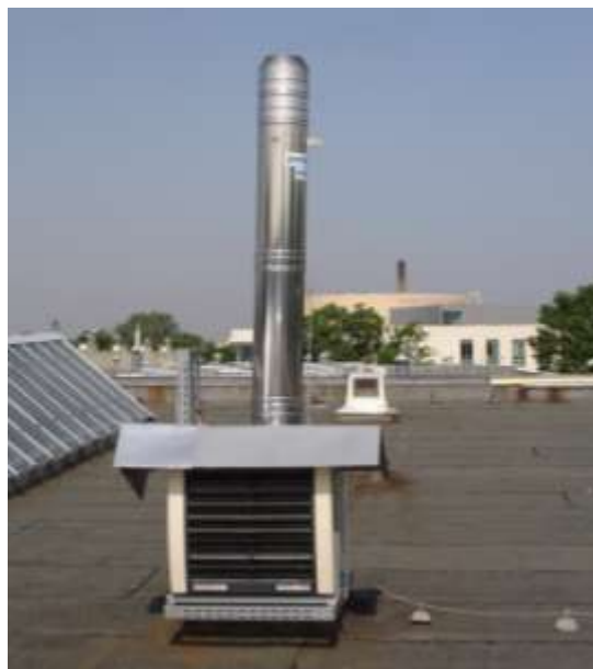
Rys. 3. Komin izolowany o średnicy 200 mm wysokości 8,5 m. i chłodnica wentylatorowa o mocy 50 kW
