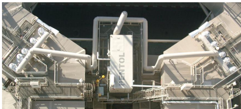
Rys. 4. Widok kontenera z instalacją rurociągów i dysz dawkujących SO 3
